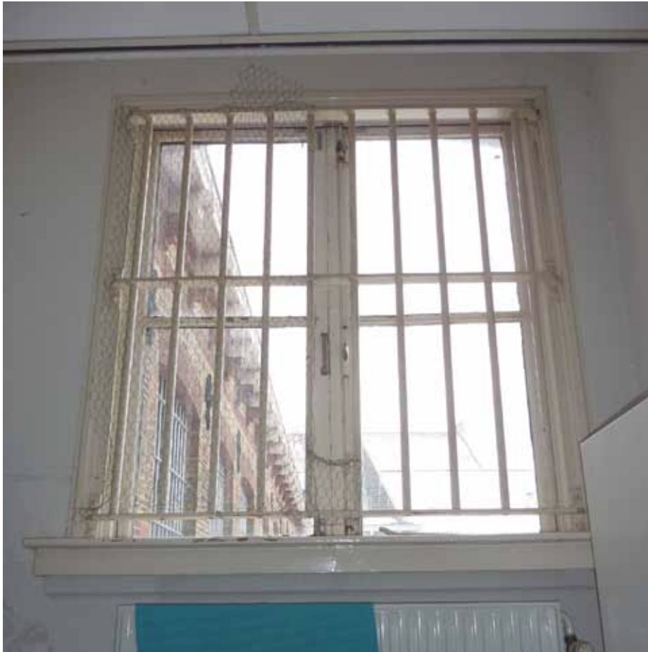
Afbeelding 104. Zicht op het venster in de westwand (buitengevel) van ruimte H1.01. Dit venster werd gelijk met dit deel van de gevel aangebracht in 1948 bij het overdekken van het 'plat boven de keuken' . In tegenstelling tot de andere getraliede vensters van bouwdeel D, bezit dit venster tralies aan de binnenzijde. Mogelijk werd hiervoor gekozen in verband met het aanzicht van de westgevel (bouwdeel E), waar bij geen van de overige vensters tralies werden aangebracht (Afbeelding 24).
