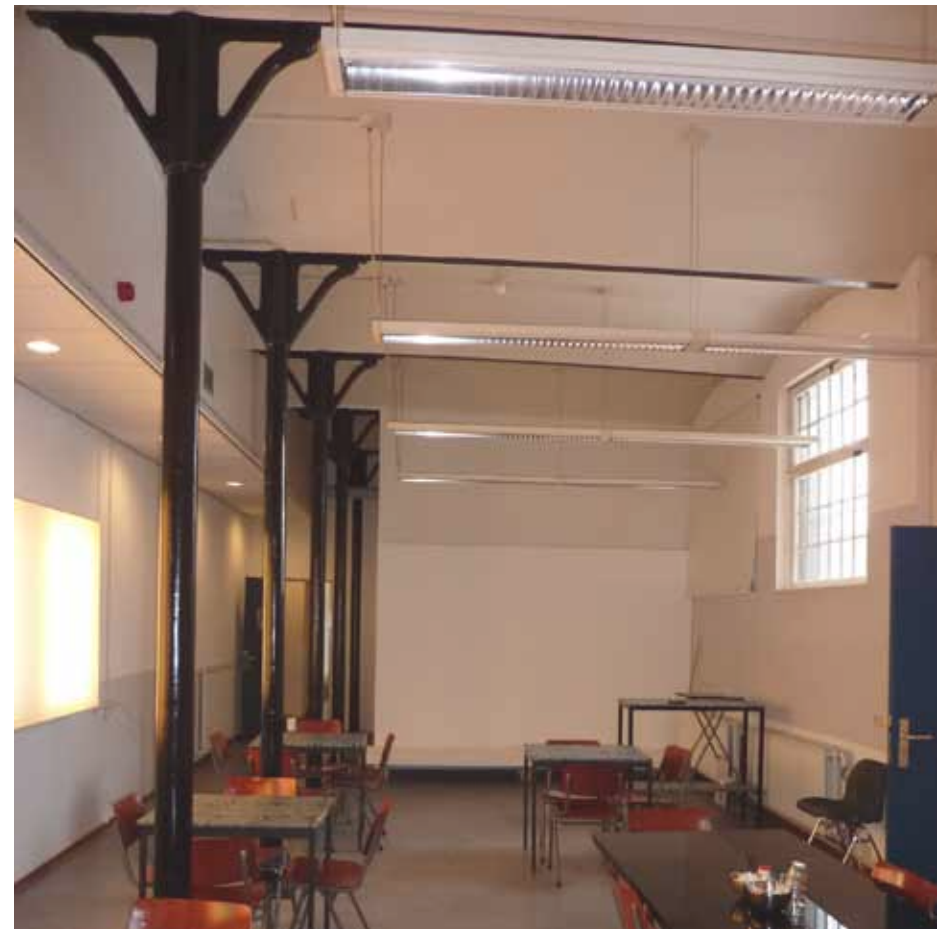
Afbeelding 100. Overzicht van ruimte H1.03 gezien richting het westen. De buitengevel (noord) is geheel voorzien van voorzetwanden (1988), waardoor het ventilatiesysteem boven de vensters (1874) aan het zicht is onttrokken. De verschillende binnenwanden in deze zone werden in 1988 ingebracht.
