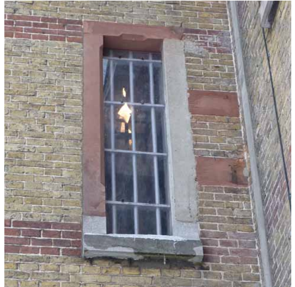
Afbeelding 19. Detail van het venster waar de rechter Udelfanger zandstenen stijl vervangen is door een betonnen stijl. Tevens is de ingekaste hemelwaterafvoer te zien die is afgesmeerd met cement.
