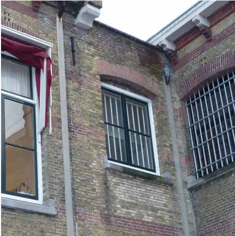
Afbeelding 25. In 1948 werd het vroegere 'plat boven de keuken' ingevuld, waarbij de westgevel inclusief speklagen werd doorgetrokken. De hardstenen dorpel werd bij het nieuwe venster hergebruikt en was afkomstig van het venster in de vroegere buitenwand, die zich ter plaatse van de huidige gangwand bevond.
