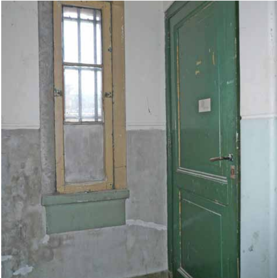
Afbeelding 37. Zicht op de toegang tot het voormalige privaat op de eerste verdieping gezien richting het noorden. De paneeldeur stamt vermoedelijk uit de bouwtijd, net als het 3-ruits venster met zinken roeden in de noordwand. De - oorspronkelijk Udelfanger - linker stijl van het venster is vervangen door een gecementeerde stijl.
