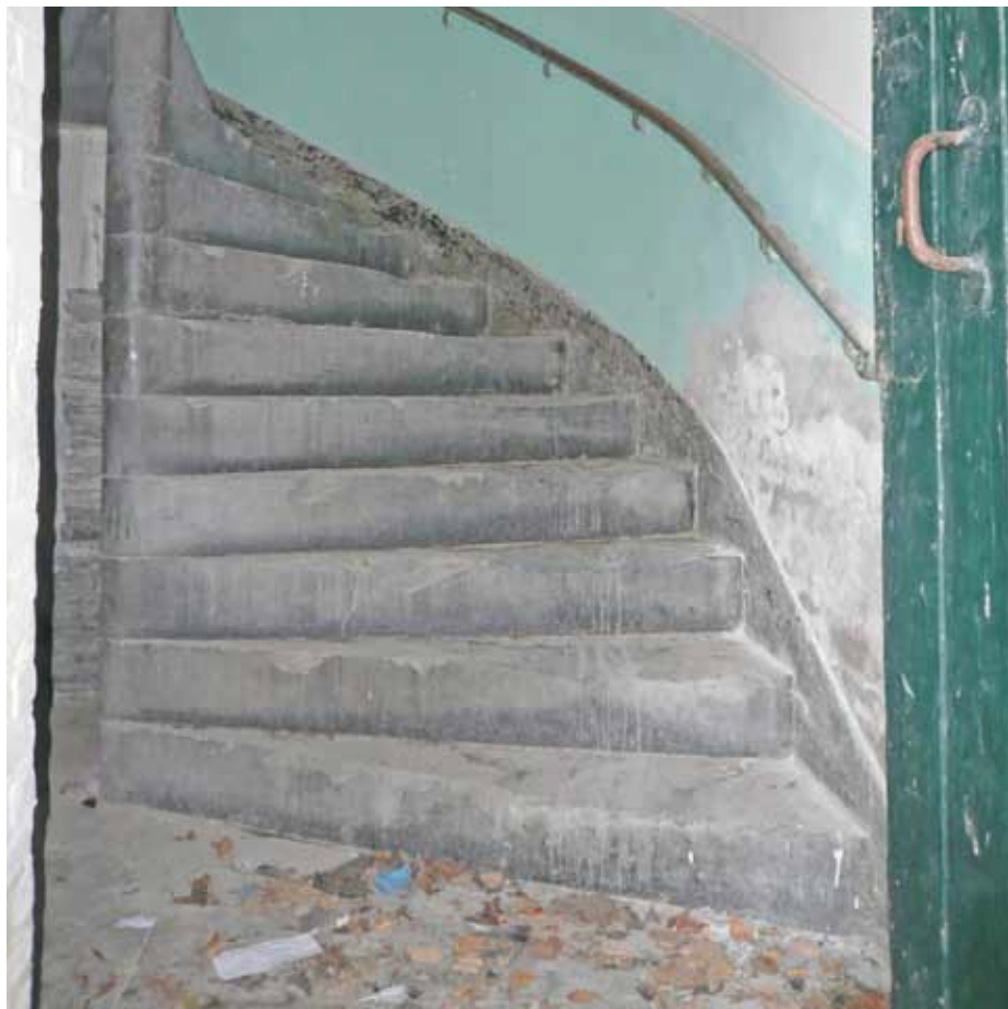
Afbeelding 133. De cementvloer van de begane grond is voorzien van ingekaste voegen op een raster van 50 x 50 cm. De vloer is gescheurd en diverse malen gerepareerd.
