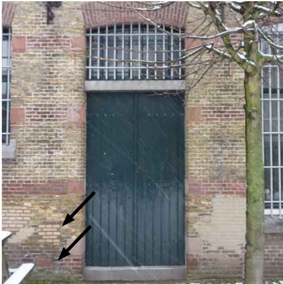
Afbeelding 16. Overzicht van de deur in de westgevel ter hoogte van de zesde gevelas. Naast grotere herstellingen - vermoedelijk vorstschade - zijn links van de deur twee kleine inboetingen zichtbaar ter plaatse van de pijlen.
