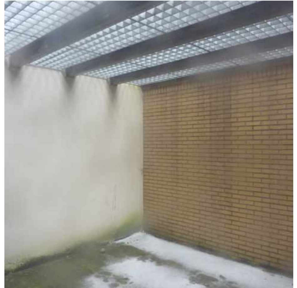
Afbeelding 55. Zicht in de luchtplaats A0.40. De ruimte is aan de bovenzijde afgedekt door middel van roosters.
