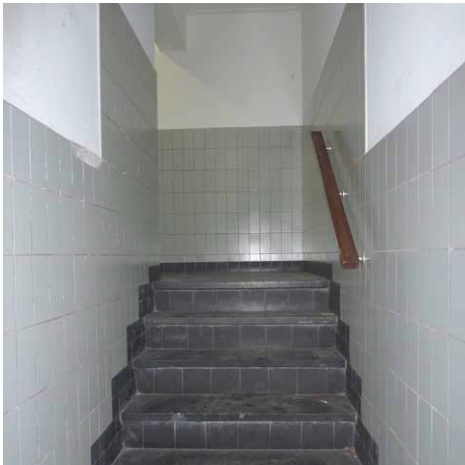
Afbeelding 43. Zicht op de eerste steek en bordes van de trap. Bij het verleggen van de ingang van het trappenhuis (XXb) werd deze steek nieuw aangebracht en aangesloten op de bestaande tweede steek van de trap. (Vergelijk Afbeelding 109 met Afbeelding 124.)
