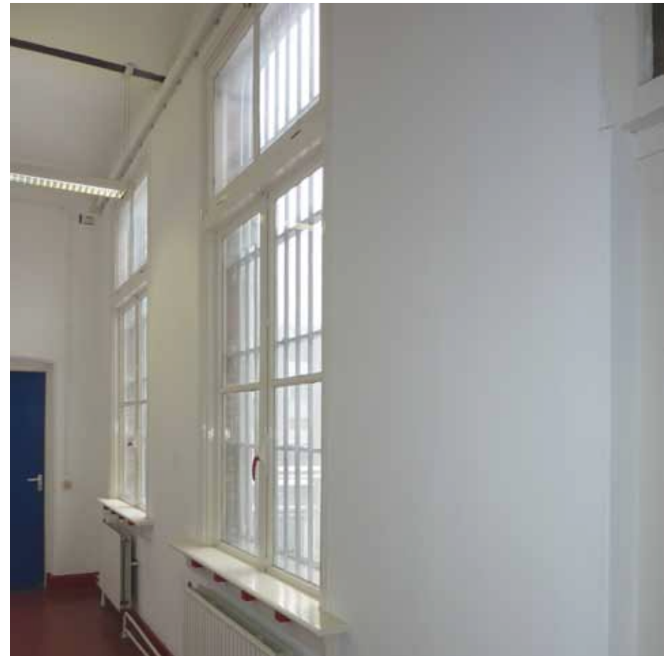
Afbeelding 58. Zicht op het linker deel van de oostwand. De vensters zijn verlengd (XXc) (zie Afbeelding 7), voorzien van 2-ruits stopramen aan de onderzijde en 2-ruits kleppende bovenramen. De houten vensterbanken op houten klosjes zijn geplaatst op de - vermoedelijk - lager herplaatste hardstenen onderdorpels.
