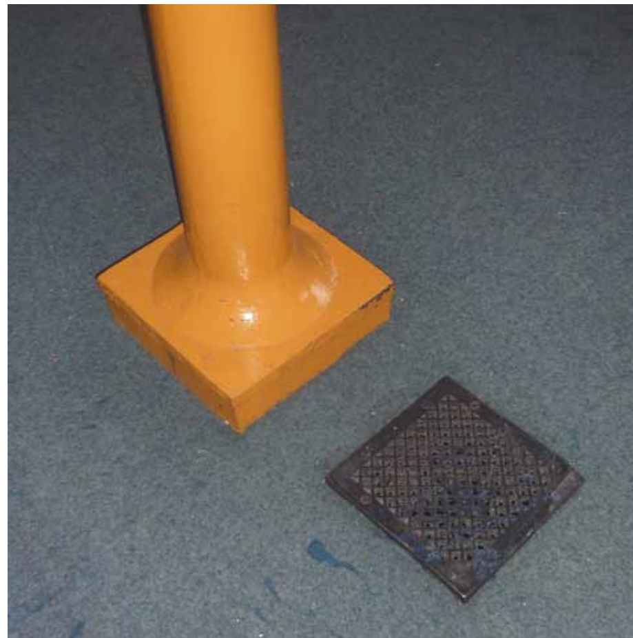
Afbeelding 92. Detail van de voet van één van de kolommen. De gietijzeren kolommen zijn door middel van vierkante voetplaten bevestigd op hardstenen basementen. In de vloer zijn vier gietijzeren roosters aangebracht, ten behoeve van de ventilatie van de onderliggende vloerconstructie.
