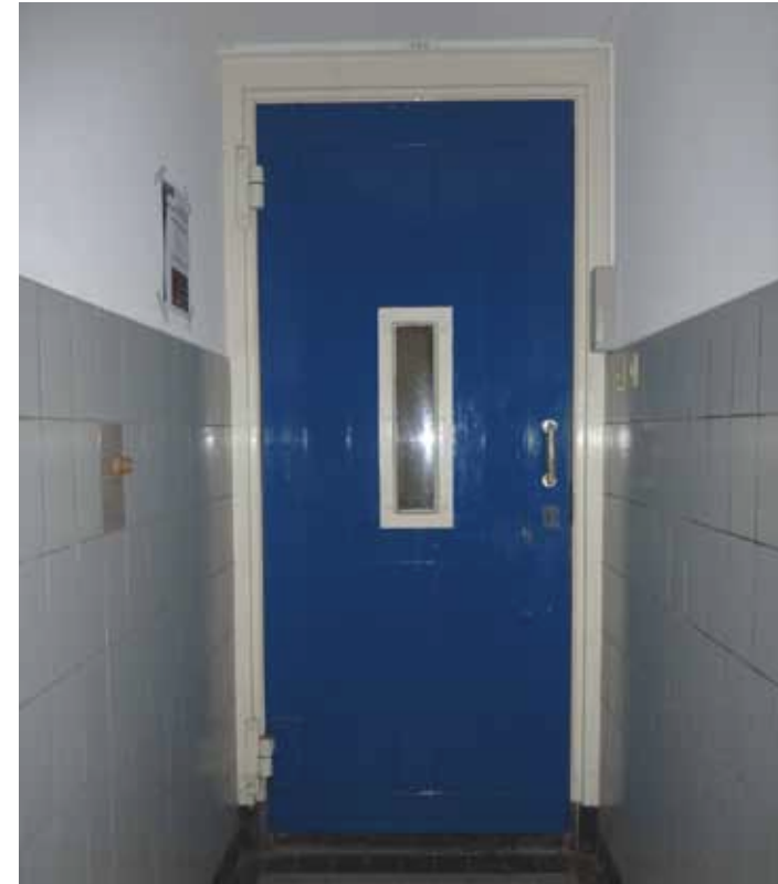
Afbeelding 42. Zicht op de toegangsdeur van het trappenhuis gezien richting het zuiden (poort). Ter plaatse van de rubberen doorstop zijn twee gespikkelde vloertegels aangebracht in het verder lichtgrijze tegellambris.
