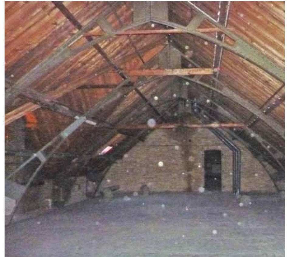
Afbeelding 93. Overzicht van ruimte F2.02 gezien richting het noorden. De brandmuren vertonen op verschillende plaatsen roetsporen en uitgespoeld voegwerk.
