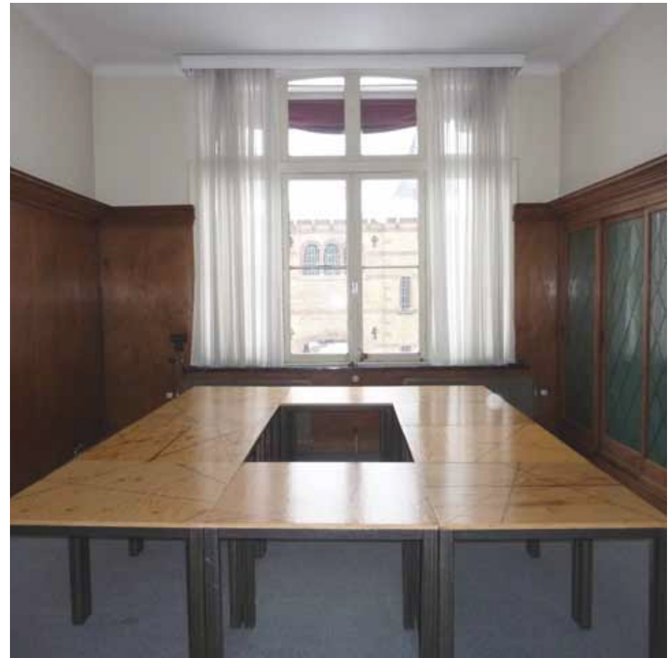
Afbeelding 75. Overzicht van ruimte F1.22 gezien richting het westen. Het interieur van de ruimte werd in de jaren 1950 aangepast, waarbij de huidige lambrisering en schouw werden aangebracht.
