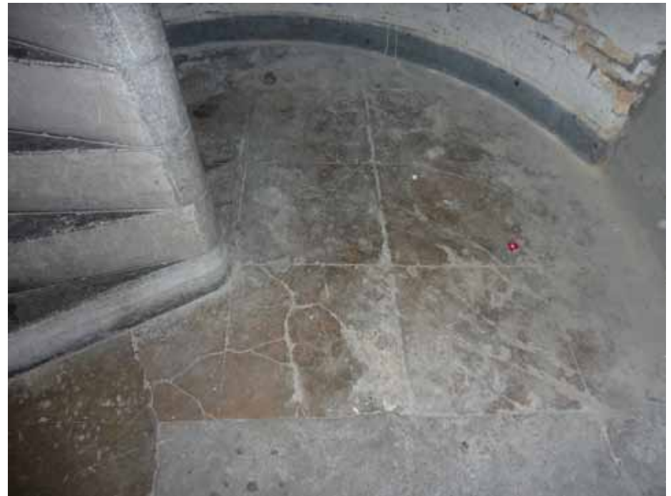
Afbeelding 106. De cementvloer van de begane grond is voorzien van ingekaste voegen op een raster van 50 x 50 cm. De vloer is gescheurd en diverse malen gerepareerd.
