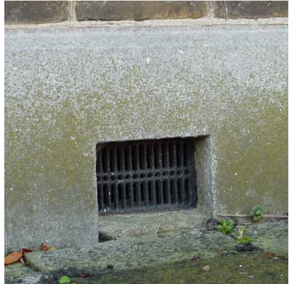
Afbeelding 10. Zicht op één van de ventilatieopeningen in de hardstenen plint. De openingen zijn voorzien van gietijzeren muizenroosters, waarvan er enkele ontbreken.
