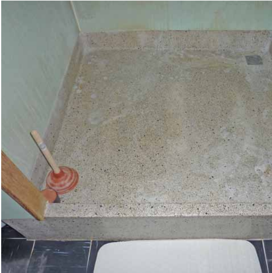
Afbeelding 48. Zicht op de terrazzo douchebak die op de houten vloer werd geplaatst.
