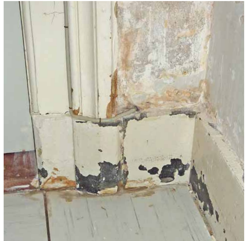
Afbeelding 20. Detail van de onderzijde van één van de doorgangen in de gang. De kozijnstijlen zijn geplaatst op hardstenen neuten en voorzien van geprofileerde aftimmerlijsten. Oorspronkelijk bestonden alle dorpels uit hardsteen, maar de dorpels naar de kamers aan de oostzijde zijn vervangen in hout. De wanden zijn aan de onderzijde voorzien van wit gesausde hardstenen plinten (1891).
