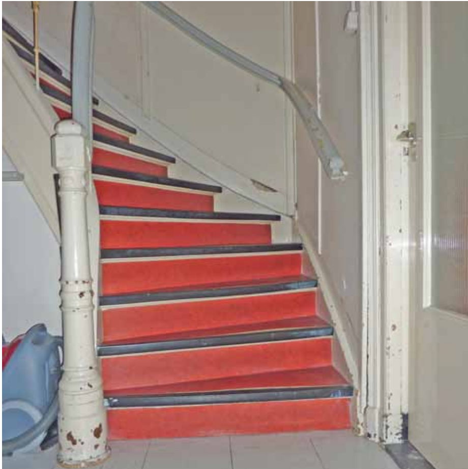
Afbeelding 59. Zicht op de onderzijde van de trap. De houten treden zijn bekleed met marmoleum en de wanden zijn voorzien van gipsplaten. Deze platen sluiten niet goed aan op de trapboom en zijn aangetast door schimmel als het gevolg van vochtproblemen.
