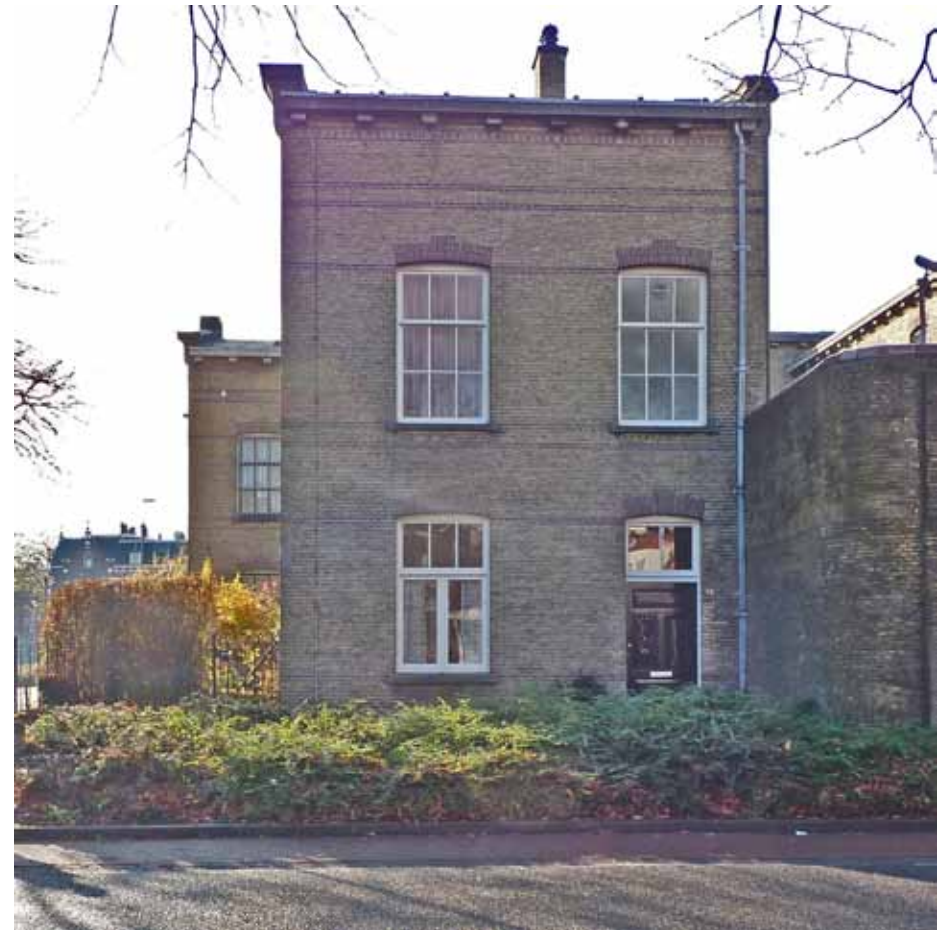
Afbeelding 4. Overzicht van de noordgevel van bouwdeel H. Ter hoogte van de begane grond werd in het begin van de jaren 1950 het 6-ruits onderraam vervangen door stolpramen. De rechthoekige hemelwaterafvoer aan de rechter zijde is uitgevoerd in zink.
