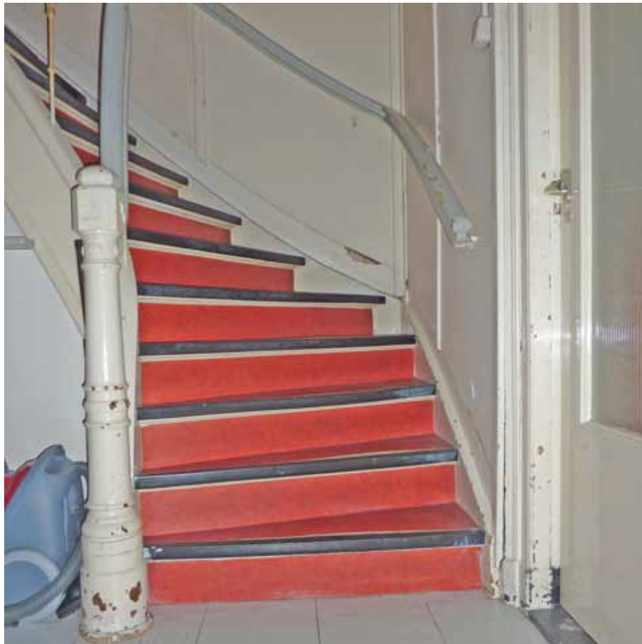
Afbeelding 19. Zicht op de onderzijde van de trap. De houten treden zijn bekleed met marmoleum (XXc) en de wanden zijn voorzien van gipsplaten (XXc). Deze platen sluiten niet goed aan op de trapboom en zijn aangetast door schimmel als het gevolg van vochtproblemen. De geprofileerde handlijst van de trap eindigt in een gedraaide houten baluster (1891).
