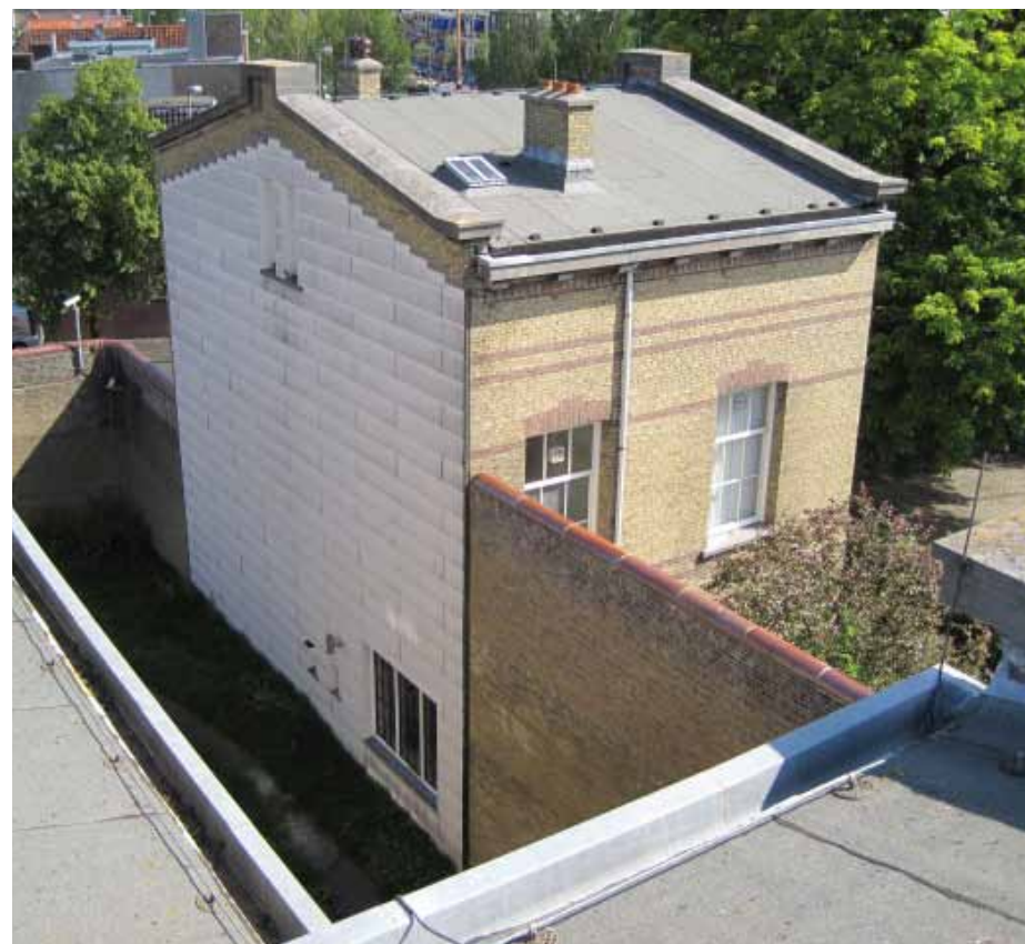
Afbeelding 55. Overzicht van bouwdeel H vanuit het zuidwesten. De recent aangebrachte eterniet beplating ontsiert de gevel en heeft bovendien het vochtprobleem niet opgelost, maar juist verergerd. Foto: dhr. Bastiaans, Monumentenwacht Overijssel en Flevoland / Drenthe 2009.
