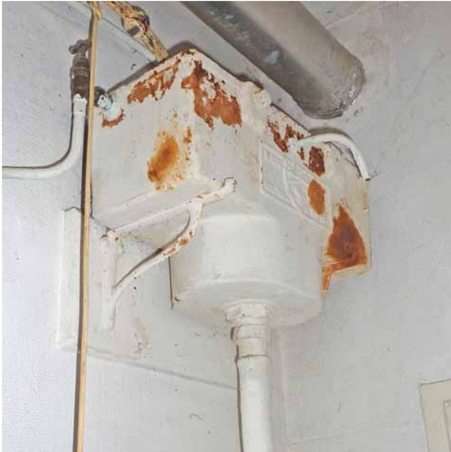
Afbeelding 22. De gietijzeren stortbak werd in de jaren '50 aangebracht tijdens de vernieuwing van het sanitair.
