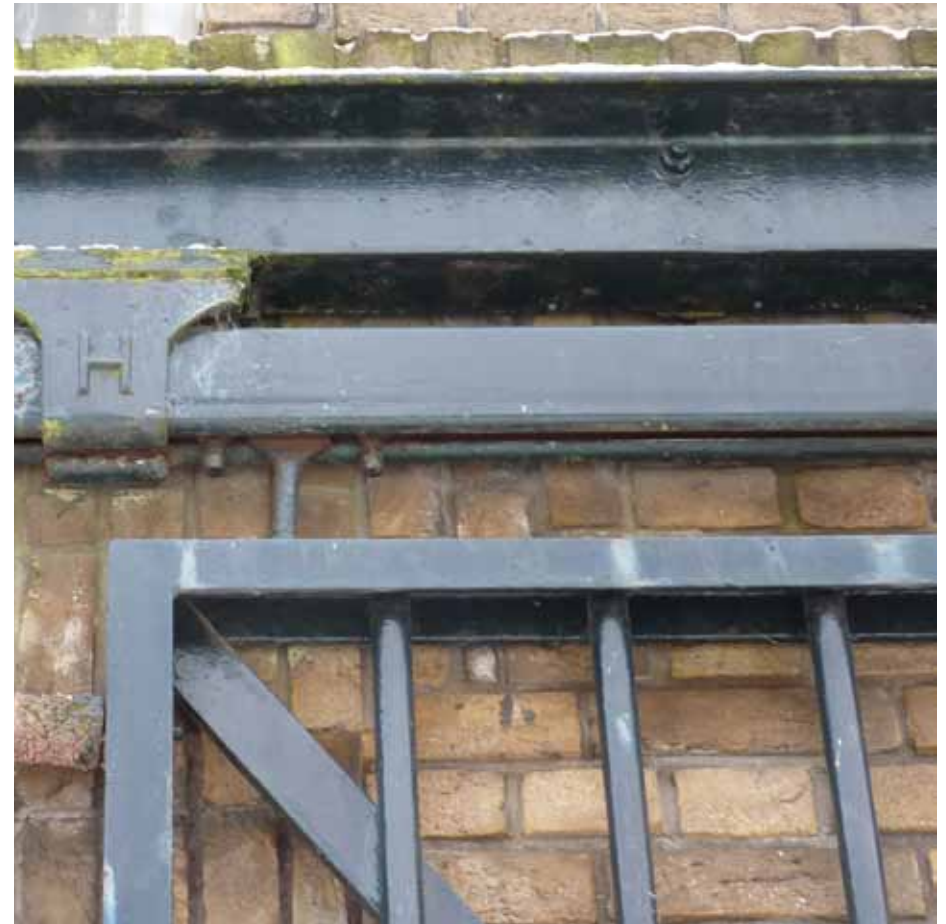
Afbeelding 9. Detail van de vorige afbeelding met het ijzeren hekwerk. Het hekwerk is secundair en dateert vermoedelijk uit de jaren '50 van de 20 ste eeuw (XXc).
