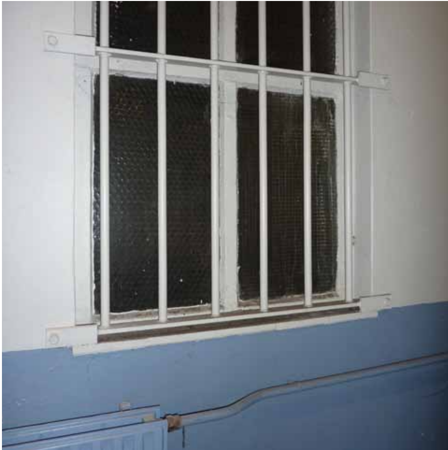
Afbeelding 23. Detail van de ramen in de voorgevel. Achter de ramen zijn traliewerken aangebracht.
