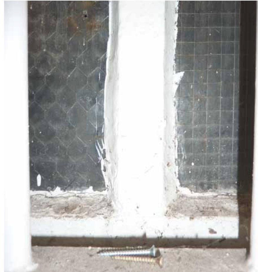
Afbeelding 24. Detail van de vorige afbeelding met de betonnen ramen, voorzien van draadglas. Het draadglas met kippengaas links dateert uit de bouwtijd (1948), en is typerend voor de materiaalschaarste in de jaren kort na de oorlog. Het glas rechts werd vermoedelijk later vervangen.
