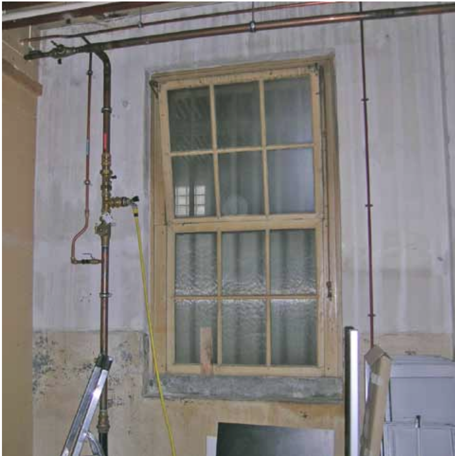
Afbeelding 125. Eén van de vensters in de achtergevel (zuidzijde) van bouwdeel A. De mogelijk uit de bouwtijd stammende (1822) schuiframen werden gewijzigd in kleppende boven- en vaste onderramen (vermoedelijk 1906) en bezitten een gecementeerde onderdorpel.
