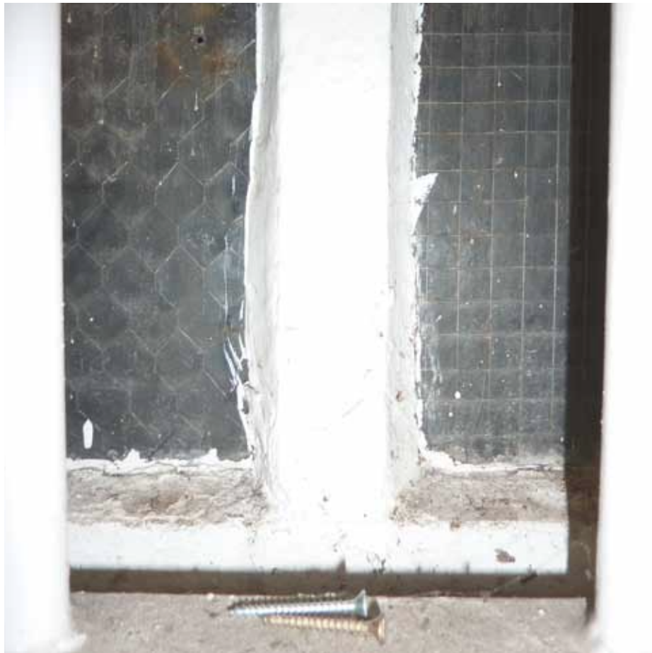
Afbeelding 140. Detail van de vorige afbeelding met de betonnen ramen, voorzien van draadglas. Het draadglas met kippengaas links dateert uit de bouwtijd (1948), en is typerend voor de materiaalschaarste in de jaren kort na de oorlog. Het glas rechts werd vermoedelijk later vervangen.
