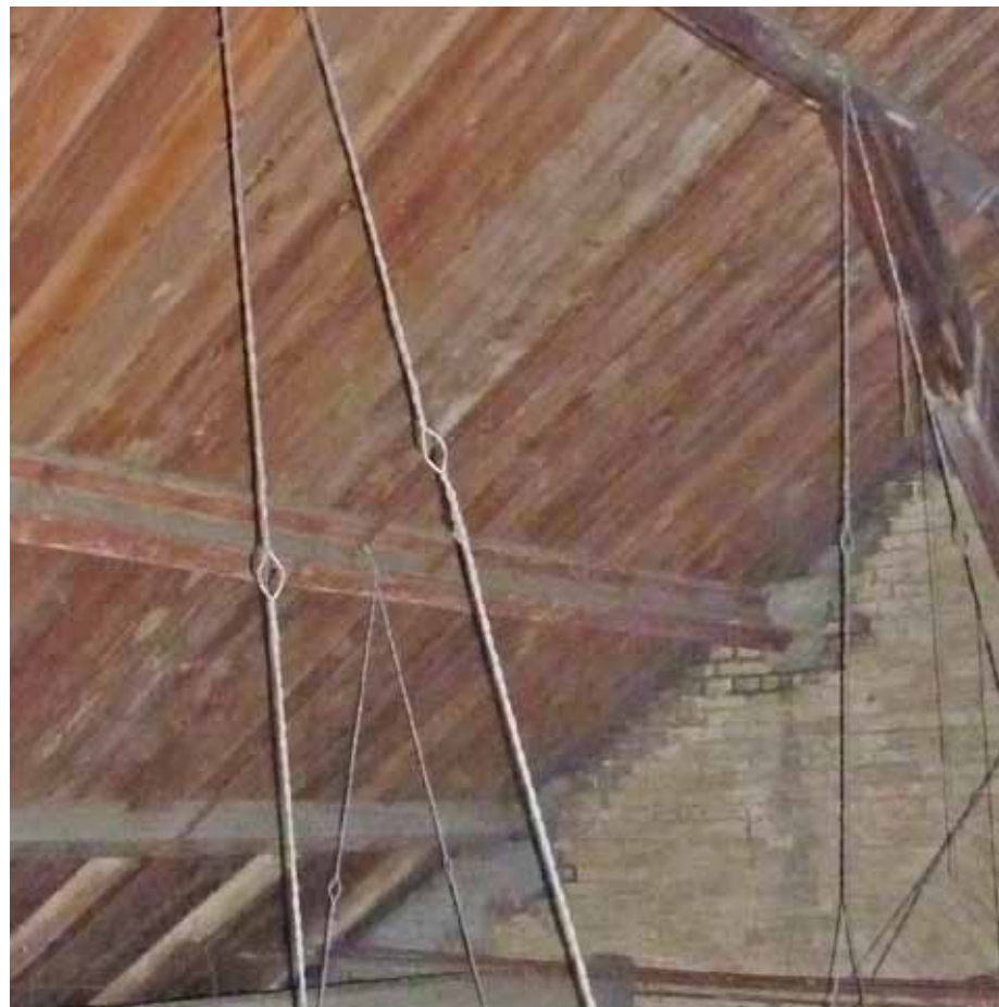
Afbeelding 98. Detail van de oplegging van één van de gordingen op de bouwmuur.
