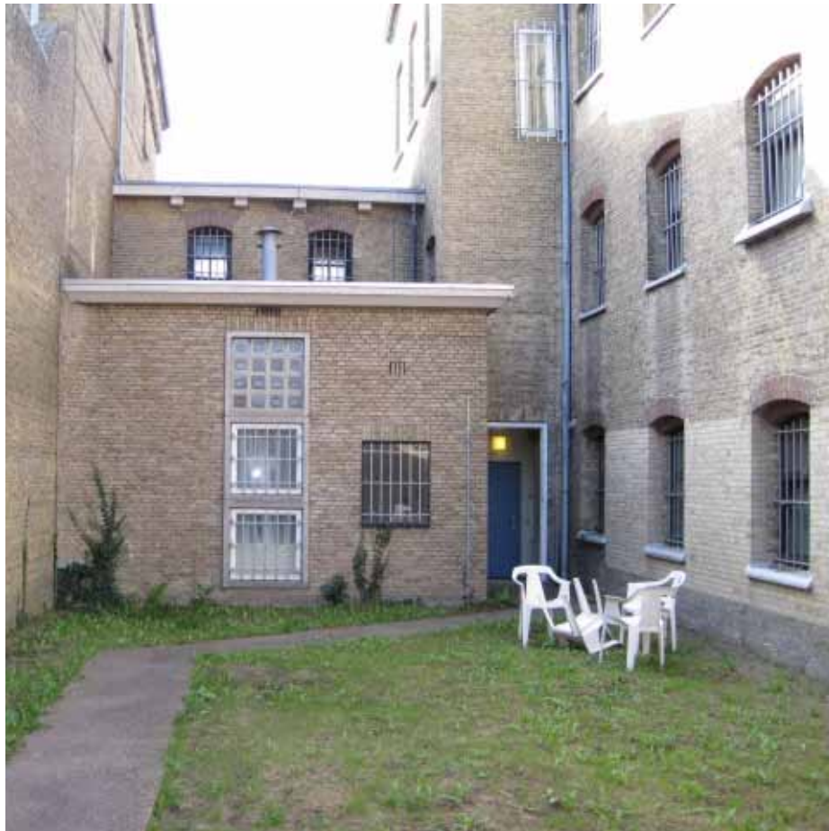
Afbeelding 144. Zicht op de noordelijke gevel van de verbindingsgang tussen de bouwdelen F (rechts) en G. In 1957 werd de verbindingsgang in zowel noordelijke als zuidelijke richting uitgebreid ten behoeve van het realiseren van een nieuwe badvoorziening en bergruimten. De gang ter hoogte van de eerste verdieping behoort wel tot het oorspronkelijke ontwerp van W.C. Merzelaar.
