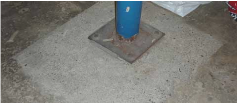
Afbeelding 78. Onderzijde van de hierboven afgebeelde kolom. De instorting rond de voet van de kolom geeft aan dat deze secundair is ten opzichte van de vloer (1988).
