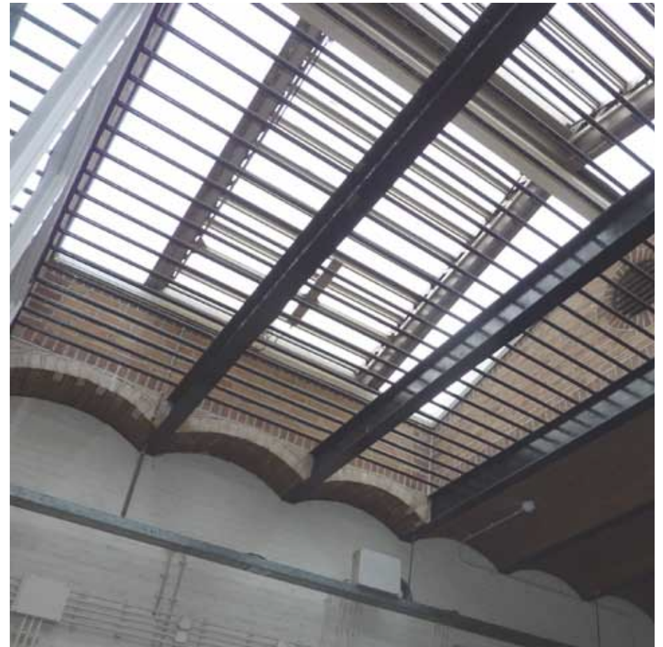
Afbeelding 59. Zicht op de onderzijde het secundaire daklicht (1964) in de cellenhal van bouwdeel F. De kopschotten bestaan uit schoon metselwerk met geknipte voegen, echter in een van het overige werk afwijkende steen. Ter plaatse van de troggewelfjes geeft de lichtere kleur van de bakstenen aan dat de stenen werden ingezaagd. Aan beide zijden is één van de drie ramen voorzien van ventilatieschoepen (1988), de overige ramen bezitten draadglas.
