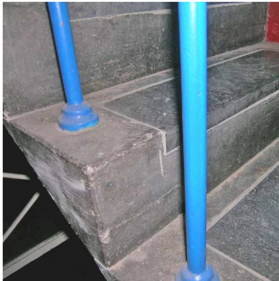
Afbeelding 153. Detail van één van de trappen. De sterk uitgesletten treden op de begane grond werden tijdens één van de laatste verbouwingen voorzien van nieuwe ingelijmde stroken hardsteen (1997).
