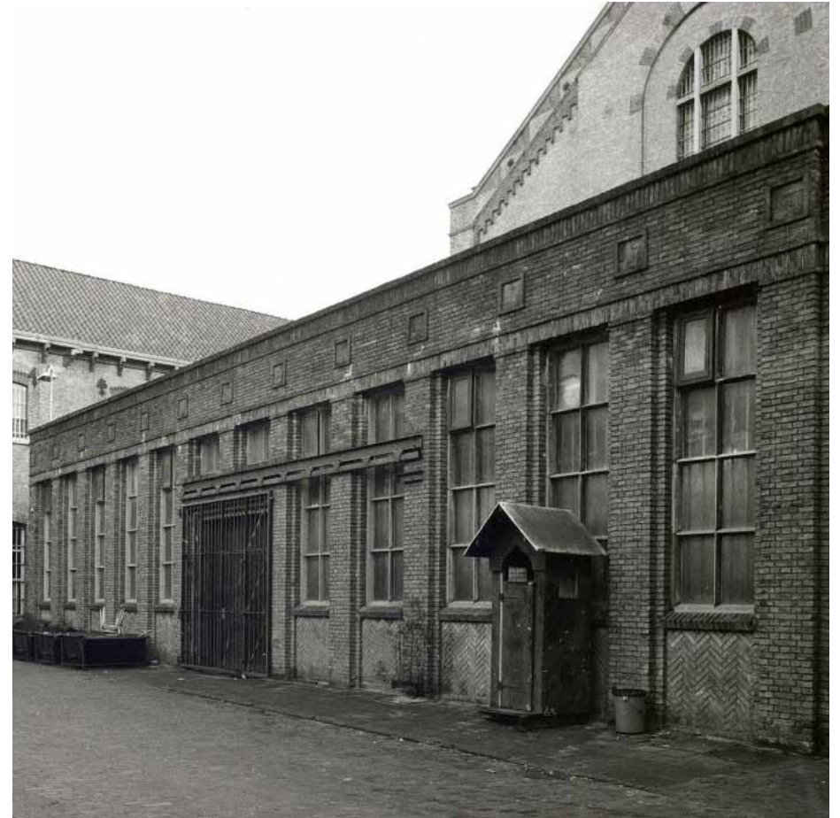
Afbeelding 139. Zicht op de noordgevel van de smederij in februari 1983. De bovenramen van de vensters bezitten hun fijne roedenverdeling niet meer. Tegen de gevel was een wachthokje geplaatst. Foto: Collectie Beeldbank Leeuwarden, documentnr.: FDBLHSPLB045.
