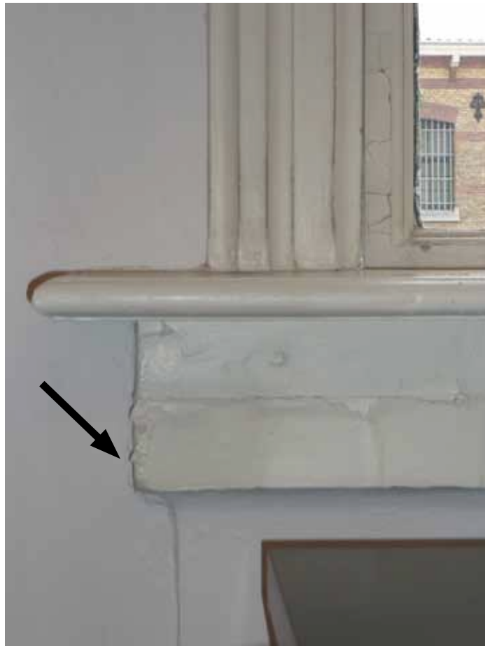
Afbeelding 51. Detail van de linker onderhoek van één van de in 1948 verlengde vensters in de oostgevel van bouwdeel E. De hoog geplaatste kleine vensters in de ruimten F1.24 en F1.25 werden verlengd, waarbij de huidige kozijnen, lijsten en vensterbanken werden aangebracht. De hardstenen onderdorpel (pijl) werd hierbij vermoedelijk herplaatst.
