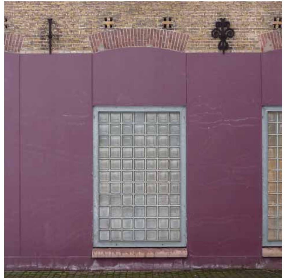
Afbeelding 149. De westgevel van de keukenvleugel is ter hoogte van de begane grond voorzien van een aubergine gesausde pleisterlaag (1997). Boven deze pleisterlaag zijn nog vier segmentbogen in rode baksteen zichtbaar. Onder de segmentbogen in de derde, vierde en vijfde vensteras zijn vensters (1997) aangebracht uit glazen bouwstenen met een betonnen omlijsting en een betonnen onderdorpel.
