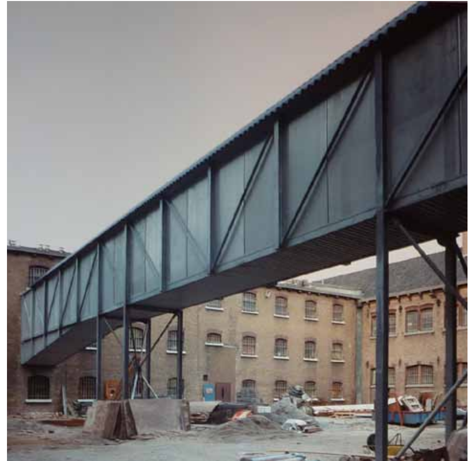
Afbeelding 66. Zicht op de net gerealiseerde loopbrug over de eerste binnenplaats. De loopbrug was voorzien van geperforeerde beplating, vergelijkbaar met de - nu roestende - beplating van het trappenhuis aan de oostgevel van bouwdeel C. De huidige eternietbeplating dateert uit 1997, toen de in 1988 gestarte verbouwing voltooid werd. Foto: archief buro irs. Vergter.
