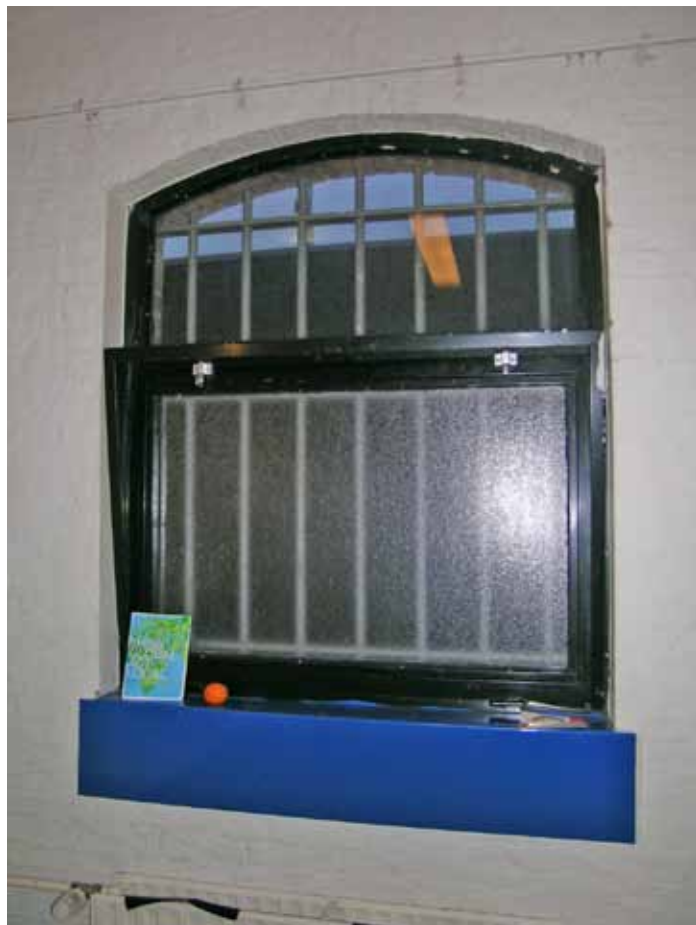
Afbeelding 74. Zicht op de binnenzijde van één van de vensters in de bouwdelen F en I. De ijzeren roedenramen werden in 1997 vervangen door grof gedimensioneerde stalen vensters. De ventilerende onderdorpel werd hierbij door middel van een stalen plaat afgedekt.
