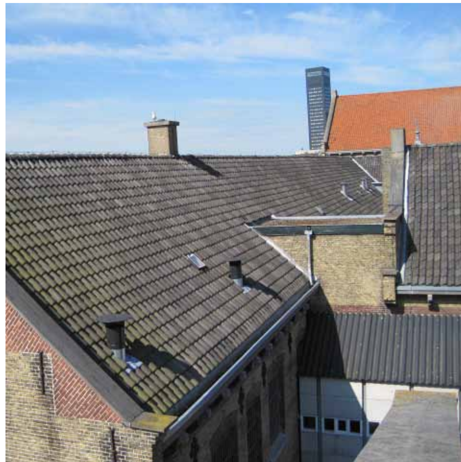
Afbeelding 114. Zicht op het noordelijk dakvlak van de oostelijke aanbouw van bouwdeel E en het oostelijk dakvlak van de binnenplaatsvleugel van bouwdeel E. De dakvlakken van de bouwdelen D en E zijn voornamelijk gedekt met in 1959 aangebrachte Romaanse pannen. Uitzondering vormen het westelijke dakvlak van bouwdeel D en het oostelijk dakvlak van bouwdeel E, deze bezitten in 1988 aangebrachte grijs gesmoorde verbeterde hollandse pannen. Foto: Dhr. Bastiaans, Monumentenwacht Overijssel en Flevoland / Drenthe 2009.
